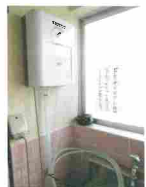
⑤FEクリーン水生成機 (次亜塩素酸水) 設置
